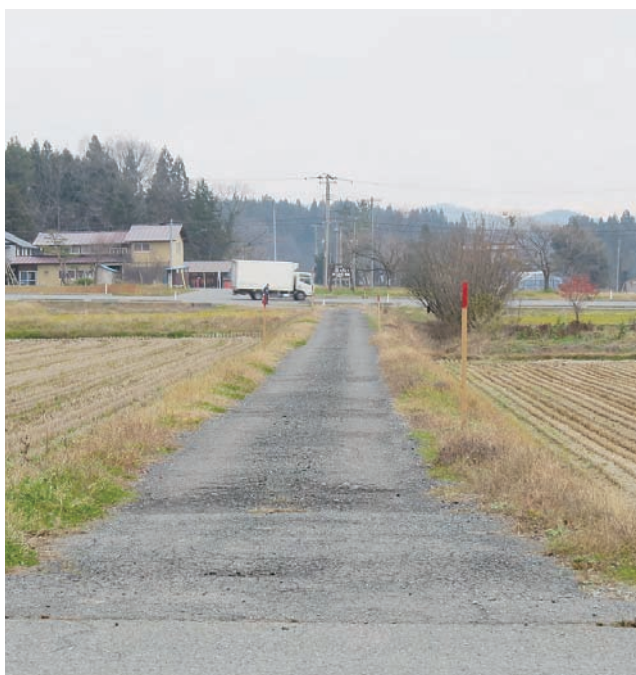
待たれる道路整備（山口沖地内）
